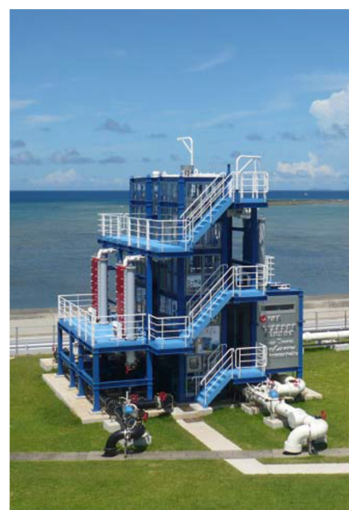
写真 沖縄県久米島に設置されている OTEC 実証試験機
