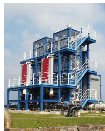
写真-3.2 久米島の実証試験設備
